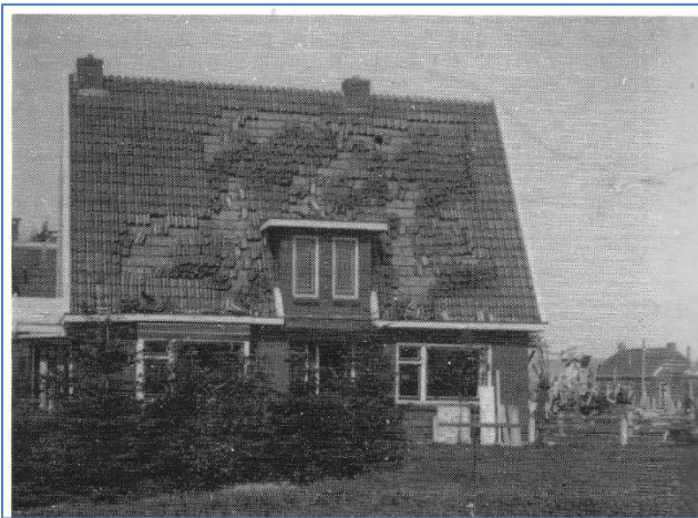
• Schade aan het dak op Weerdingerkanaal Zuidzijde 3
